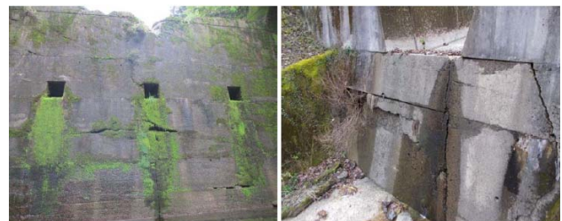
図-3 コンクリート砂防堰堤におけるひび割れの変状事例
