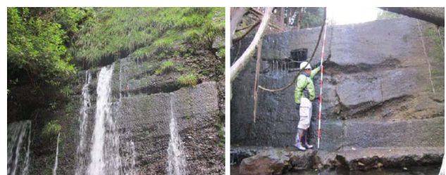
図-5 コンクリート砂防堰堤における剥離欠損の変状事例
