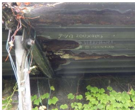
図-1 張出歩道デッキプレートの腐食
