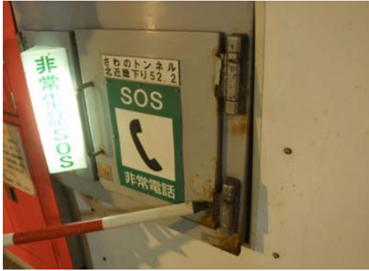
図-2 トンネル巡回点検での付属物腐食
