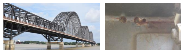
対象橋梁外観 主桁－横桁取り付け位置の疲労き裂 写真-1 写真-2
