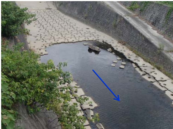
写真-4 落差工下流の護床ブロック流失状況
