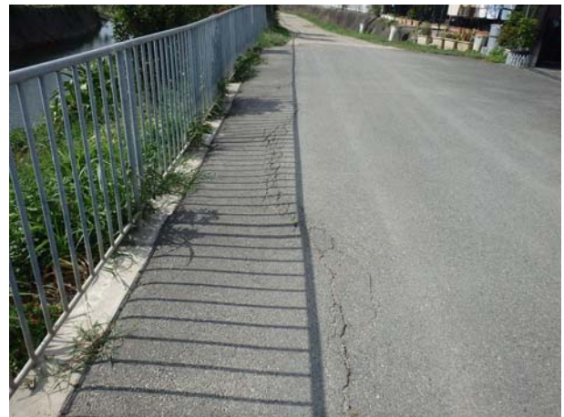
写真-1 堤防道路の沈下状況
