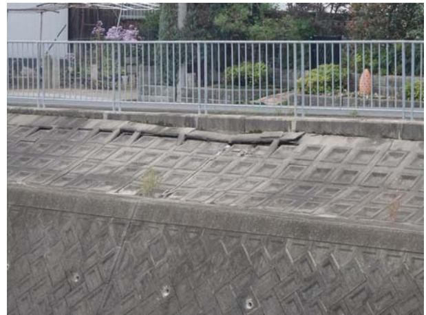
写真-2 張ブロックの沈下状況
