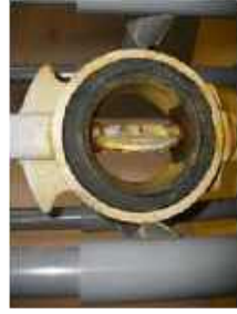
固着が発生したバルブ
