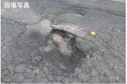
■ 路面損傷箇所
