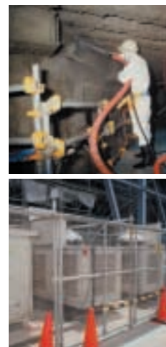
処理作業の様子と電源装置
