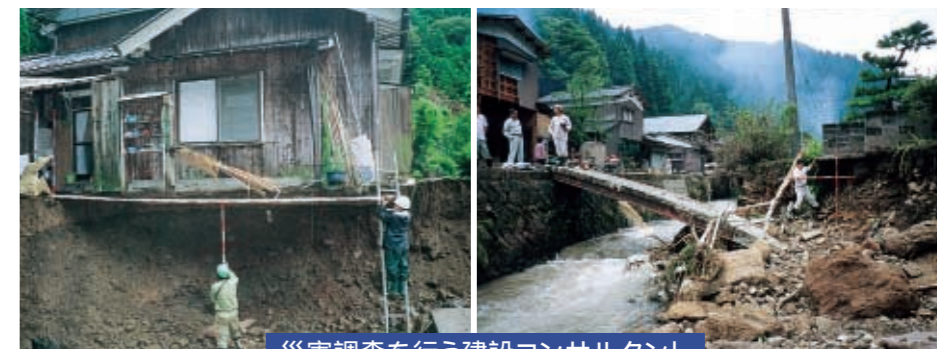
災害調査を行う建設コンサルタント
