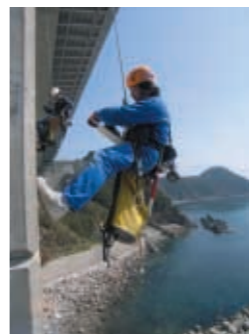
特殊高所技術者による調査 写真提供:株式会社特殊高所技術 http://www.tokusyu-kousyo.co.jp/hasi_kousyouban.html
