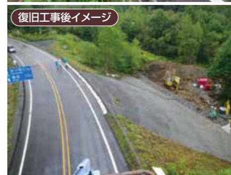
出典:平成23年度一般国道276号道路盛土崩壊の災害対応について
