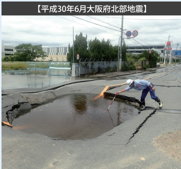
①水道管破裂による道路陥没（大阪府高槻市）
