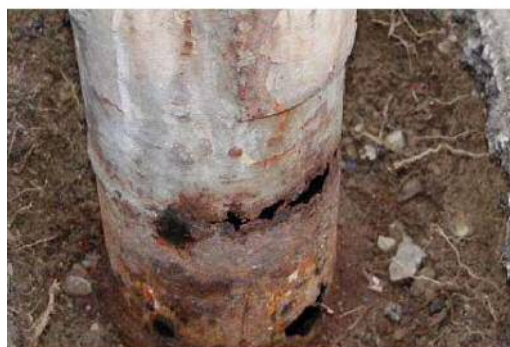
写真-2 路面境界部の腐食事例(引用文献 1) )
