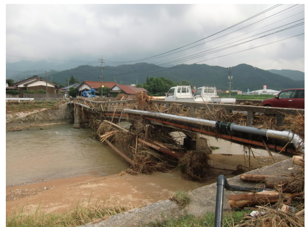
写真-1 近年に発生した橋梁における流木被害
