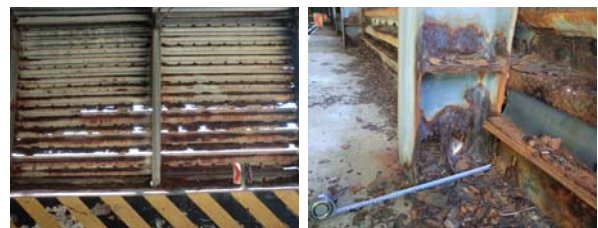
写真-2 パネル腐食状況
