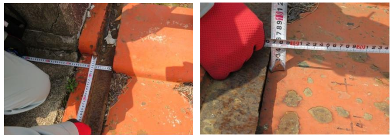
(a) 直角方向水平変位 (40mm) (b) 橋台との段差 (45mm)
