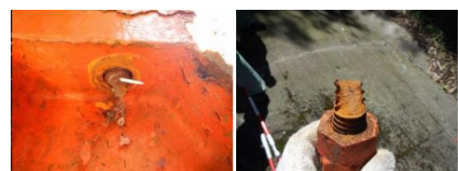
(c) セットボルトの破断 (A2 橋台側)
