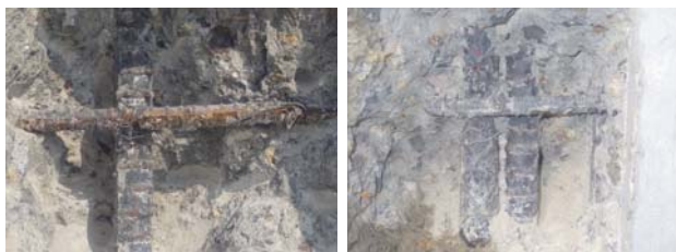
写真-2 ハツリ調査(鉄筋劣化状況)
