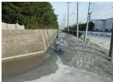
写真-1 幹線道路歩道の突き上げ被害 (千葉県浦安市)
