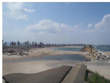
図-1 仙台湾南部海岸の堤防破壊状況 (左：陸側，右：沖側)
