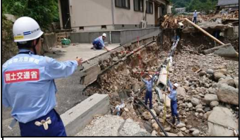
朝倉市での被災状況調査(道路)
