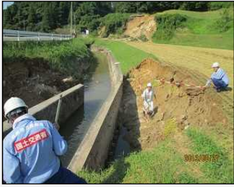
被災状況調査
