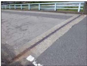
写真-9 伸縮装置(補修前)
