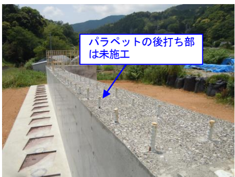
写-2 パラペット天端の状況
