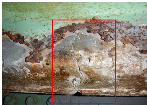
写真-2 対象箇所（露出・ひびわれ部拡大：床版支間中央付近）
