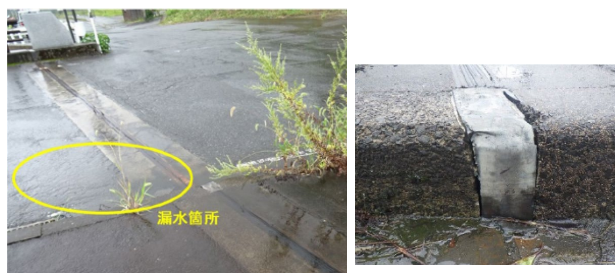
図-9 A橋における伸縮装置からの漏水事例
