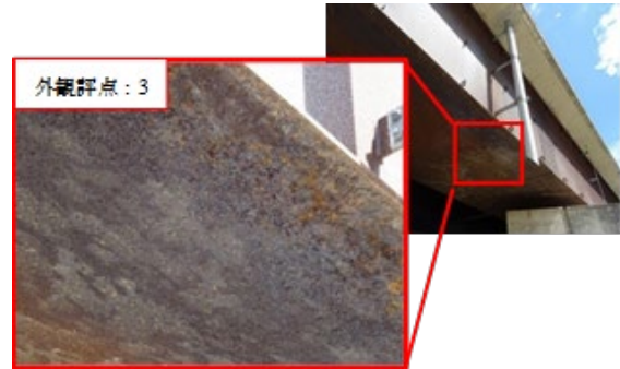
図-5 C橋の排水管周辺のさび生成状況
