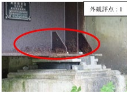
図-4 A橋のさび生成状況
