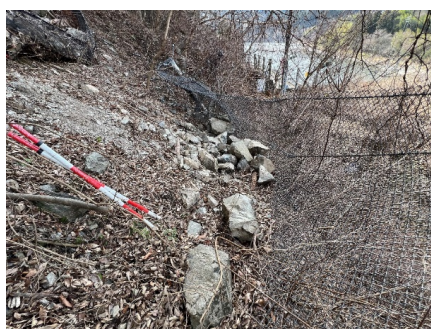
写真-2 損傷した落石防護柵
