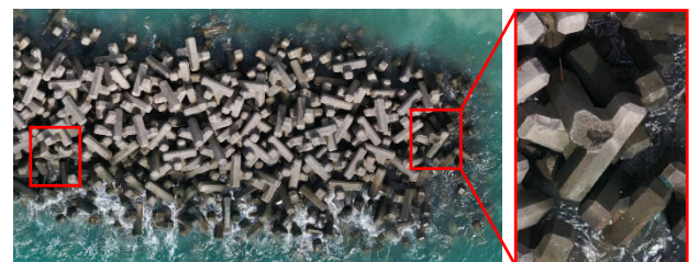
図-13 ブロックの破損
