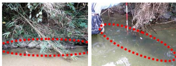
写真-2 左岸②損傷状況写真
