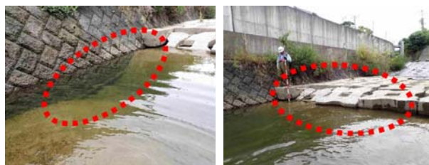
写真-3 右岸①損傷状況写真
