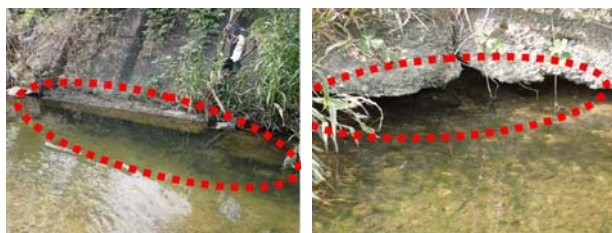
写真-1 左岸①損傷状況写真
